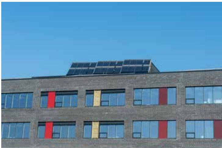
SOL: Når elevene skrur på det varme vannet i skolens undervisningskjøkken, er det varmet her, gjennom 100 kvadratmeter solfangere på skolens tak, viser Søren Marstand Hansen.
